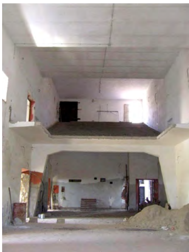
Fig. 41 - Situazione dell'ex Cinema dopo l'interruzione dei lavori del 2004. Platea e Galleria.
