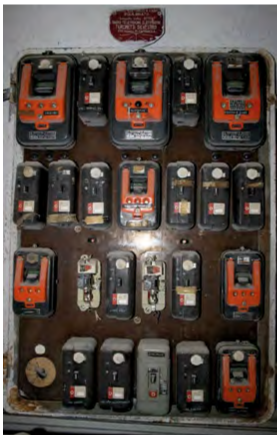
Fig. 30 – 1960 circa - Quadro elettrico generale montato secondo le normative dell'epoca.
